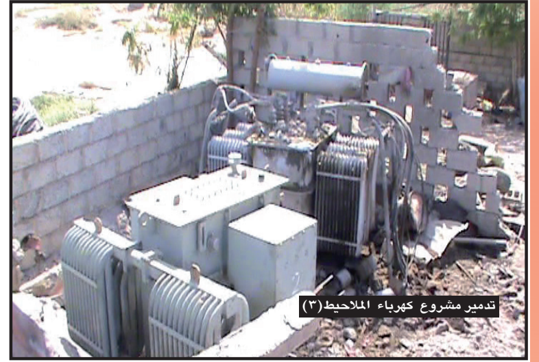
مشروع كهرباء الملاحيط (٤)
